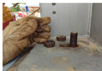
图 3 设备滑动端地 脚螺栓安装位置错误
