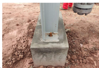
图 4 设备滑动 端基础未设置底板
