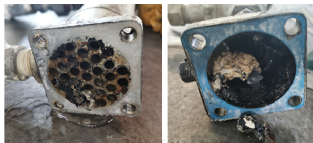
图6 冷却水管路堵塞
