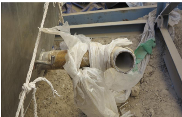
图3 到货后的接管断裂现场照片
