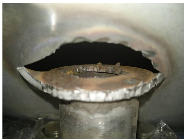
图5 撬装设备到现场后,储罐的液位计接口断裂撕开
