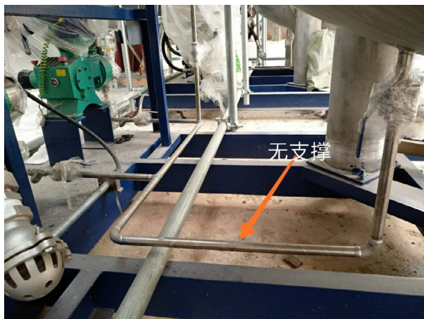
图6 撬装设备配置的管道缺少必要的支撑,悬空较多稳定性不足
