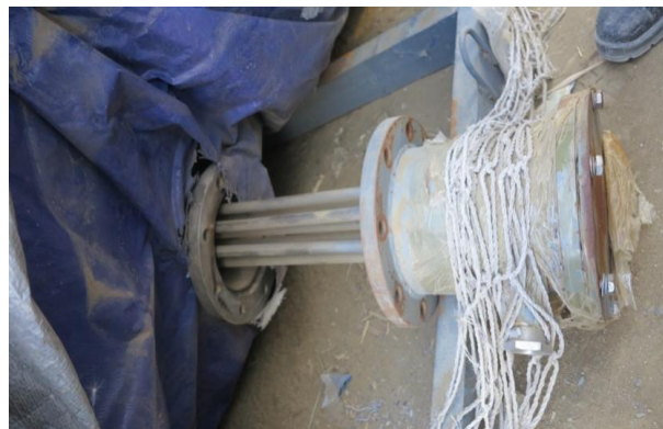
图4 到货后电加热器脱落照片
