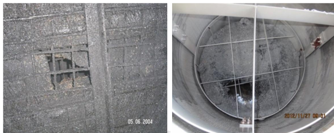
图6 丝网破损照片
