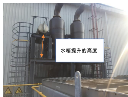
图13 改造后的膨胀水箱位置
