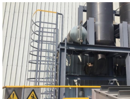
图12 改造前的膨胀水箱位置
