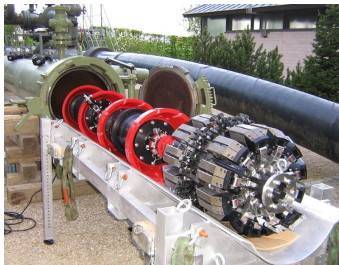
图2 智能通球可全面检测管道缺陷
