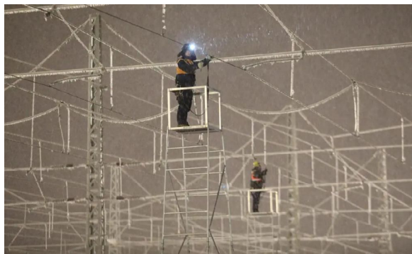
图 1 高压输电线路覆冰情况
