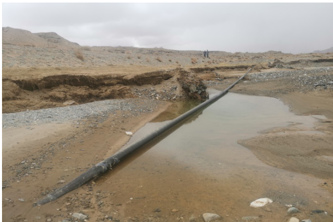
图 1 河岸坍塌导致管道裸露
