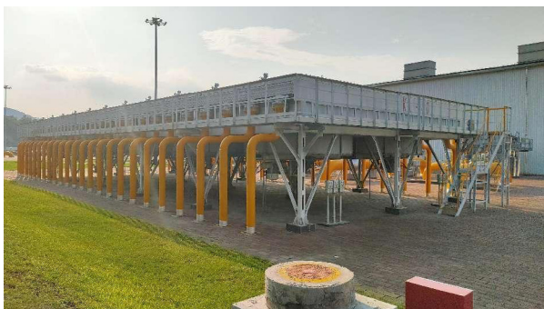
图2 压气站集中后空冷系统典型照片
