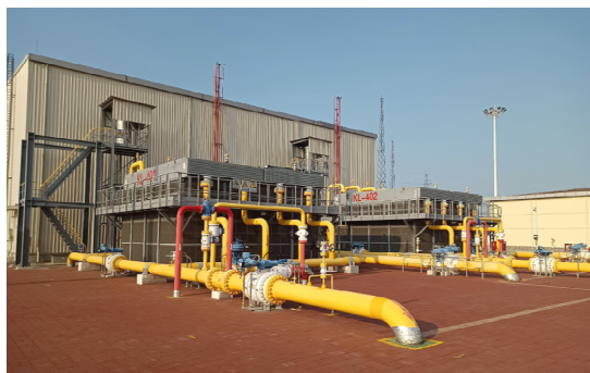
图 1 压气站独立后空冷系统典型照片
