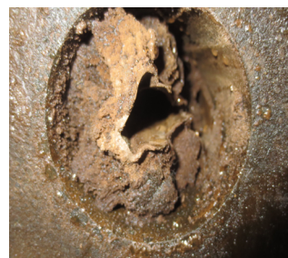
图 1 A17 井油嘴下游管道弯头结垢情况
