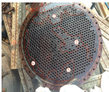
图2 脱重二塔再沸器堵塞情况
