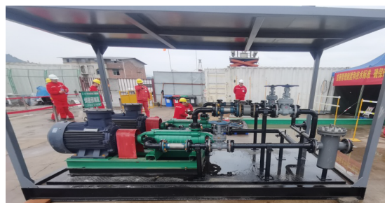
图 2 撬装化污水撬
