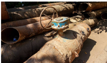
图2 石油管道受脏水腐蚀严重
