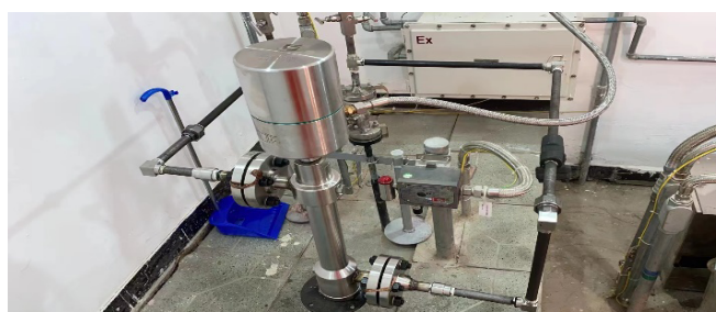
图 3 改造后现场界面监测仪应用照片
