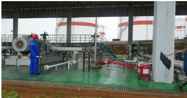
图1 输油站场现场设备
