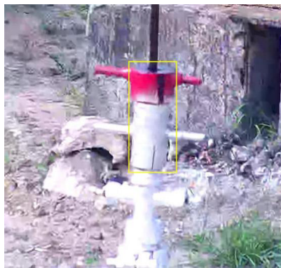
图2 盘根漏油检测
