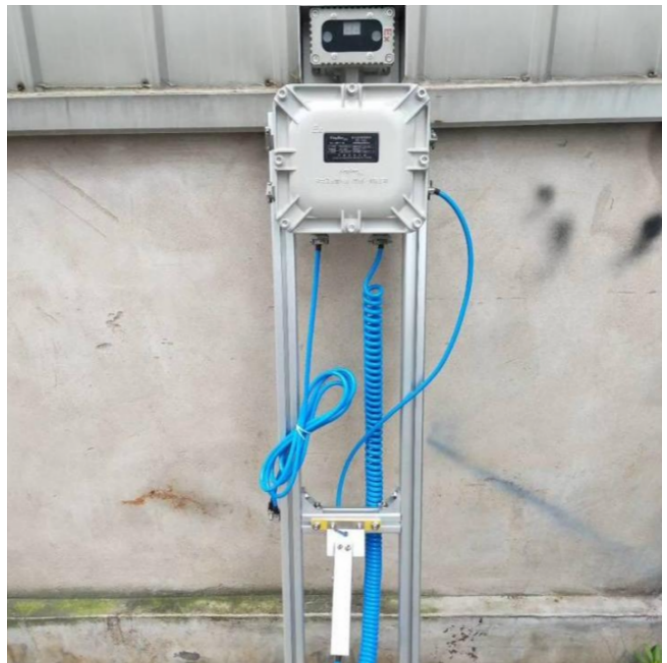
图2 油品装卸防静电溢流保护装置
